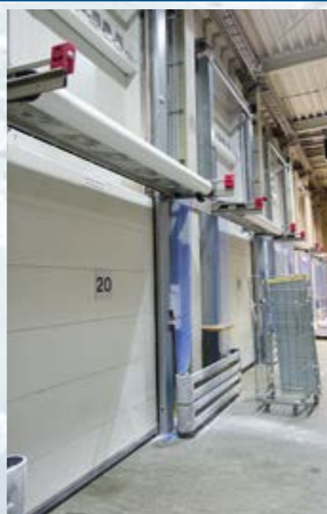
FRIGOVENT Typ A-300 i.G. im Gefrierraum bei -30°C
